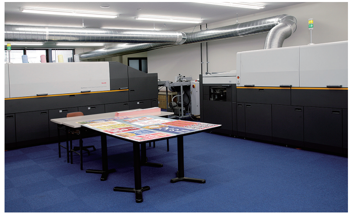
箕沖POPセンターに設置されている2台のNexPress
